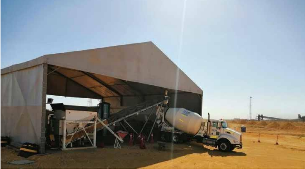
PLANTA DE CONCRETO (CLIENTE BOTADEROS)
